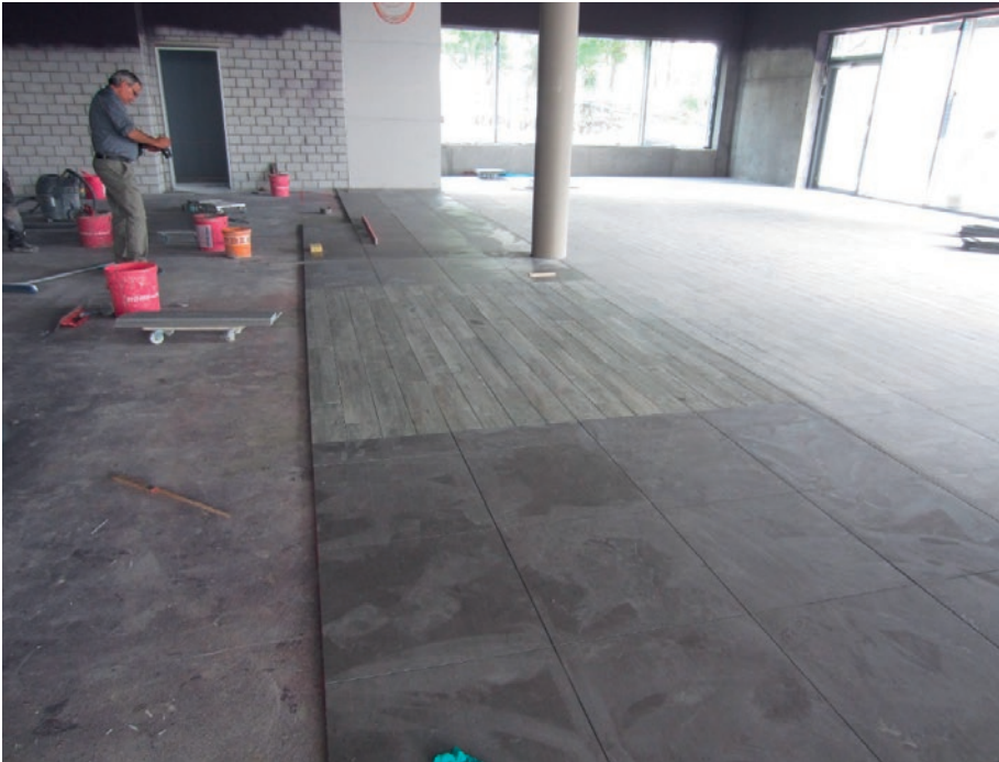
Schon nach drei Tagen konnten die Feinsteinzeugplatten auf dem noch feuchten Zementestrich verlegt werden. Mit PCI Flexmörtel S2 Rapid ist die frühe Belegung ohne Risiko möglich: Der Spezial-Fliesenkleber wirkt spannungsabbauend und entkoppelnd.
