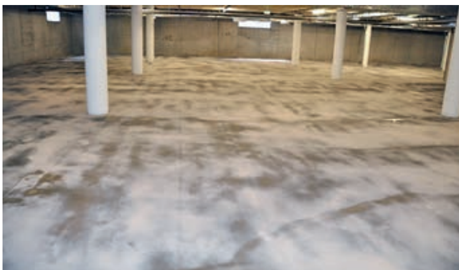
Ungenügend abgesandete Oberfläche
