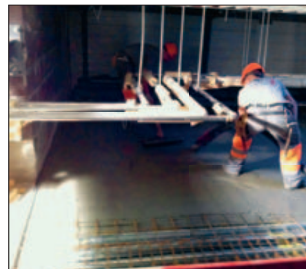
Verarbeitungsgerecht temperiert gelangt der Beton über Stahlrohre und Schläuche auch an unzugänglichen Stellen zum Einsatz.
