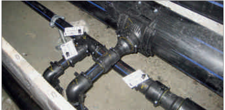
Die Vor- und Rücklaufleitungen sind am Wärmetauscherelement angeschlossen.
