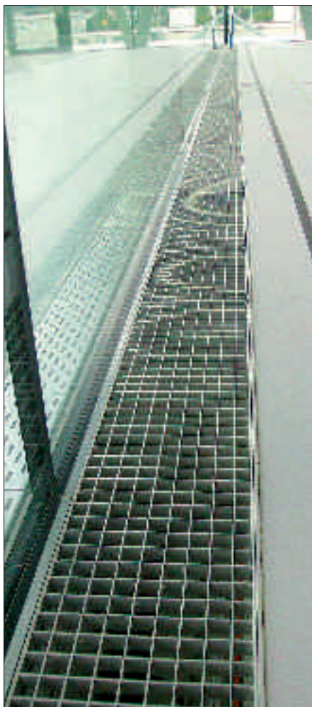
Gitterrost-Abdeckung für die Frischluftzufuhr in der Doppelturnhalle
