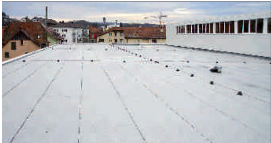
Die Grösse der Fläche des Haupt und Vordaches der Büroräume in Klingnau beträgt 1850 m 2
