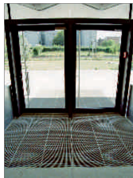
Die Schmutzschleuse besteht aus einem pflegeleichten Stahlrost
