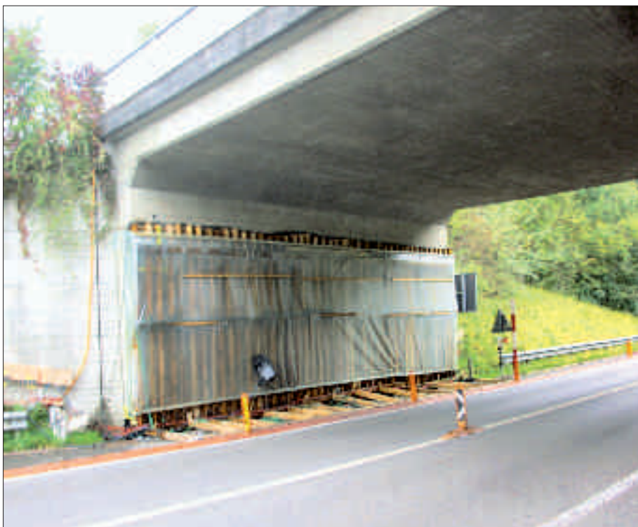
Bild 10: Widerlagerwand Tägernau-West mit Spritzschutz. Aufgrund der engen Strassenverhältnisse konnten keine New Jersey Schutzelemente gestellt werden. Für die Montagearbeiten wurde die Geschwindigkeit des Verkehrs auf 60 km/h signalisiert.
