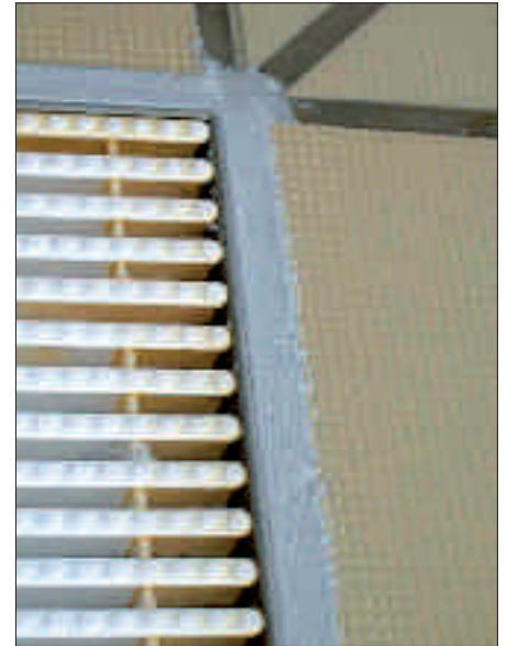
Bereits in Mitleidenschaft gezogener Dichtstoff am Beckenrand eines Hallenbades
