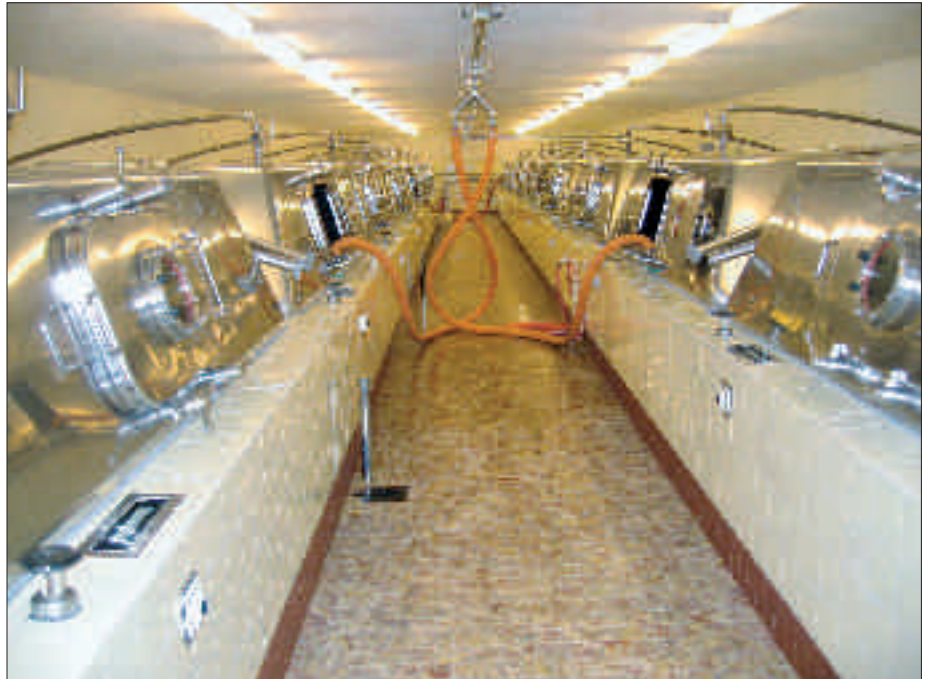
Nicht nur Chemie, auch Lebensmittel können Dichtstoffen arg zusetzen. Beispiel Anschlussfugen an Gärbecken
