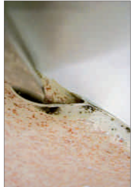
Fugendichtstoff mit Pilzbefall
