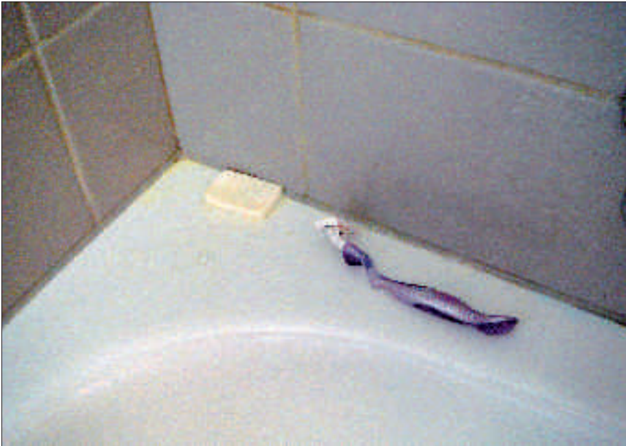
Anschlussfuge Badewanne. Die Lebensdauer dieser Fugen hängt stark von der Wartung ab
