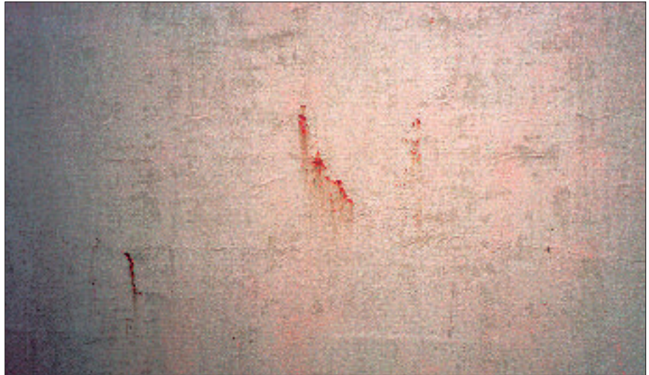
Abb. 2: Die Beschichtung hat vereinzelte Roststellen. Die Deckbeschichtung ist stark abgewittert. Hier wird mittels Ausflecken und Deckanstrich saniert.
