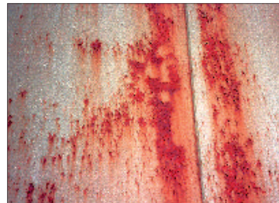
Abb. 3: Die Beschichtung ist stark verwittert und grossflächig abgeblättert. Sie erfüllt ihre Schutzfunktion nicht mehr und muss neu beschichtet werden.
